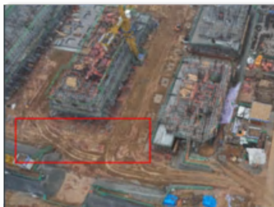
工地出入口未硬化
